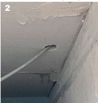
2 For stort et hul omkring ledningshullet, skulle have været fuget / Too much space around the wiring, must be grouted.
